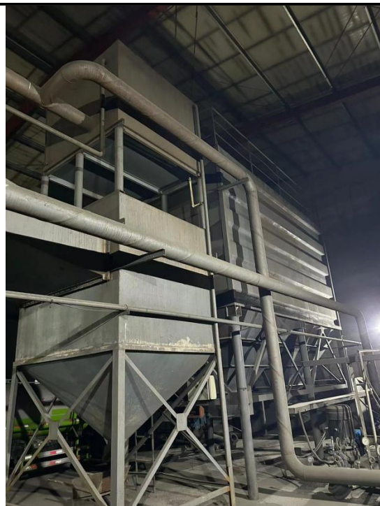
锅炉除尘设施
